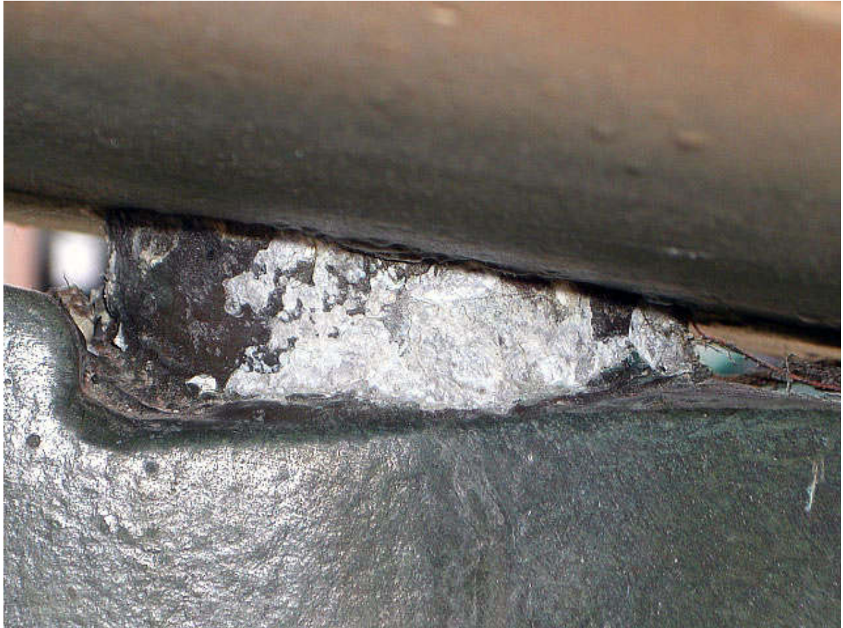
Exemple 3 de corrosion électrochimique provoquée par l'utilisation d'un anti-failling à base de cuivre en contact avec l'arbre de gouvernail.
